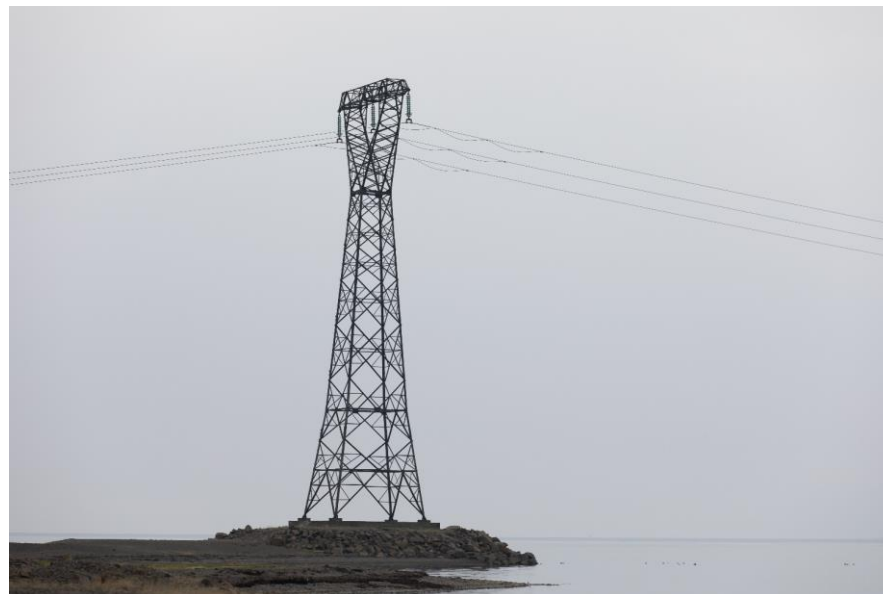
Mynd 14-1 Háspennumastur í Gilsfirði.
