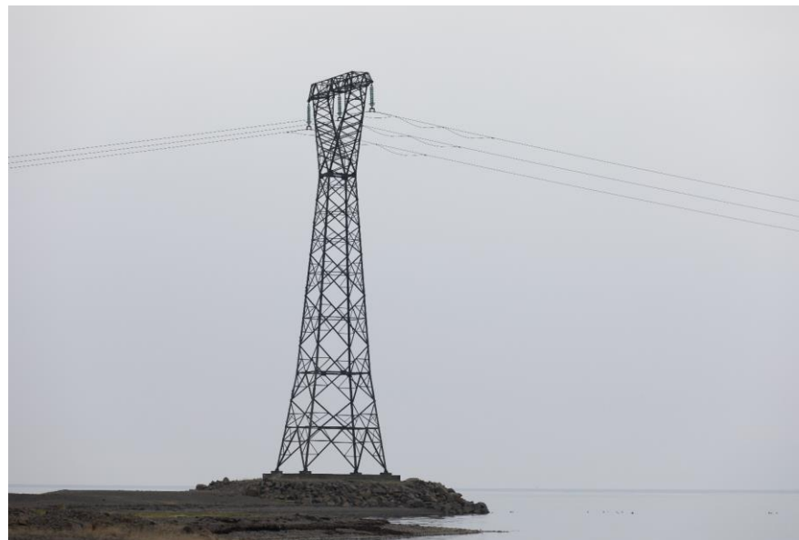
Mynd 14-1 Háspennumastur í Gilsfirði.
