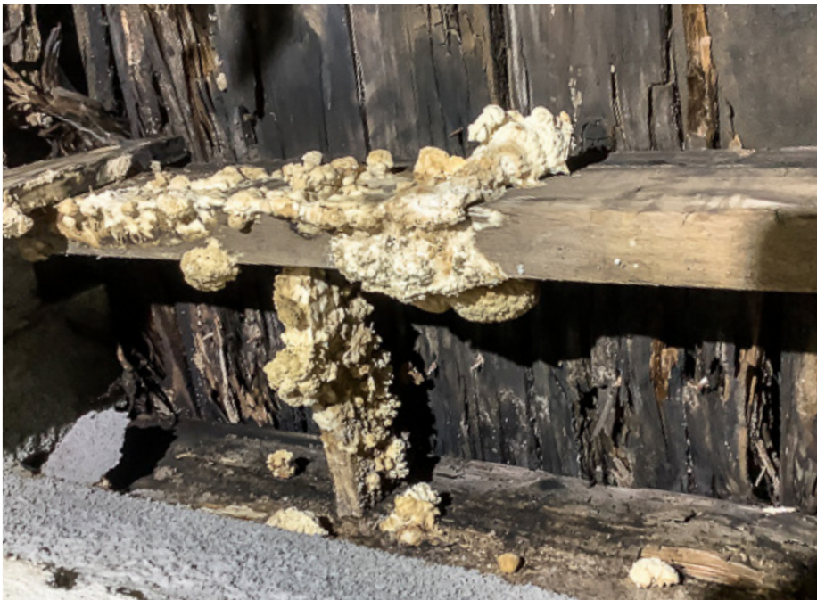
9. mynd. Sveppvöxtur og fúu í þaki í húsnæði sem myndast vegna ónógrar loftunar í þaki.
