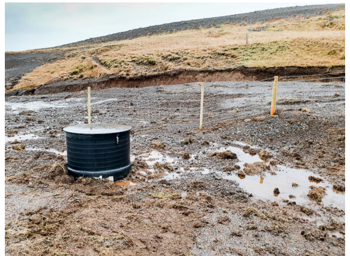
8. mynd. Vatnstökusvæði. Óæskilegur vatnssvelgur er við brunninn sem skapar hættu á yfirborðsmengun neysluvatns.
